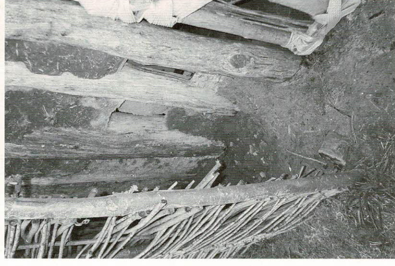
Abb. 7. Auf der wetterexponierten Westseite des Hauses von Pennigbüttel B treten regelmäßig – nach starken Regenfällen – Auswaschungen und Rutschungen im Stampflehm der Hauswand auf (Foto R. Keim).
